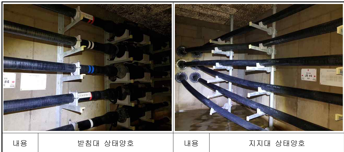
【사진 9.4】 부속 및 부대설비 현황
