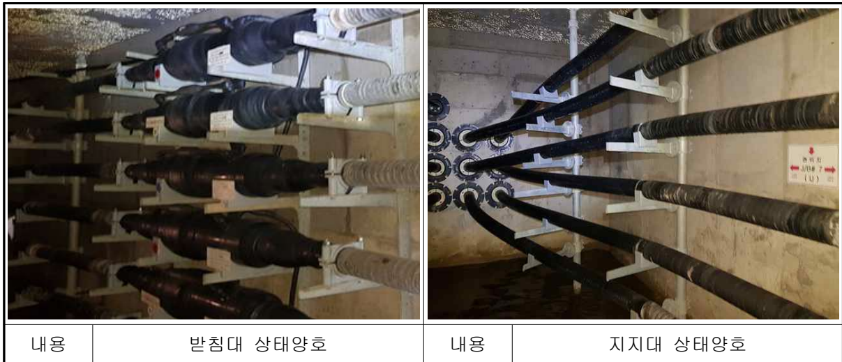
【사진 9.28】 부속 및 부대설비 현황
